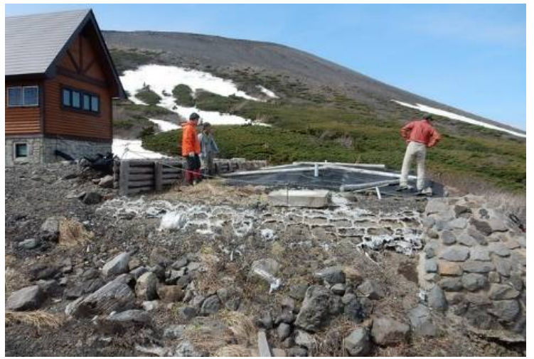
仮押さえ完了・・・抜本的補修が必要である
