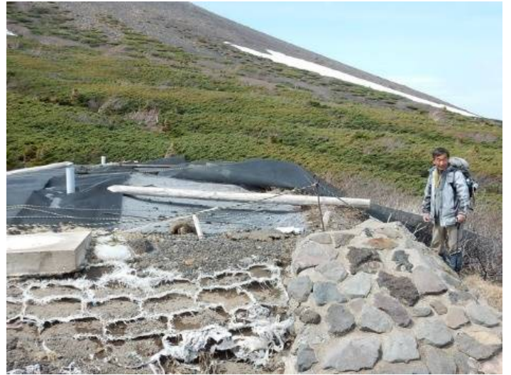
浄化用土壌抑えのネットがめくれ、土壌が飛散している
