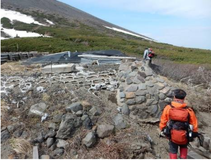
八合目小屋別棟トイレ浄化施設:強風でネットがめくれていた
