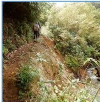
路肩崩壊部 (H1,240m付近)
