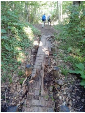
木道腐朽状況 (丸森川付近)
