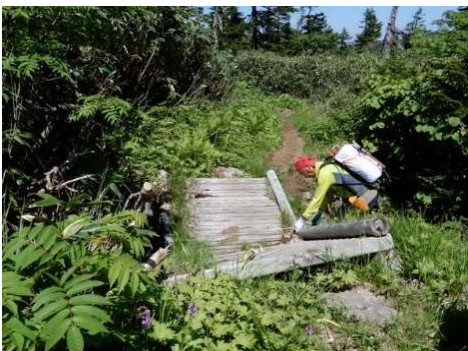
木橋桁折れ 通常時は右側（人物側）を 通行出来るが・・・
