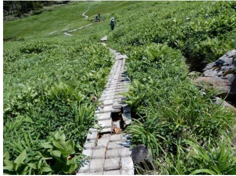
木道破損状況（湿原内に数ヶ所あり）
