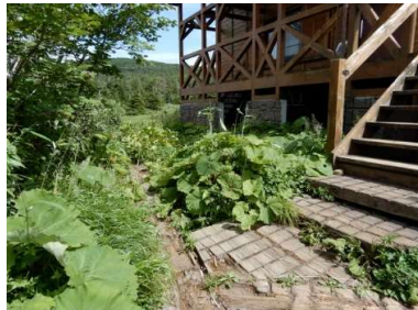
山荘前の木道も腐朽しているが今のところ特に支障なし
