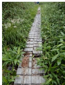
木道腐朽 三ツ沼南約140m付近
