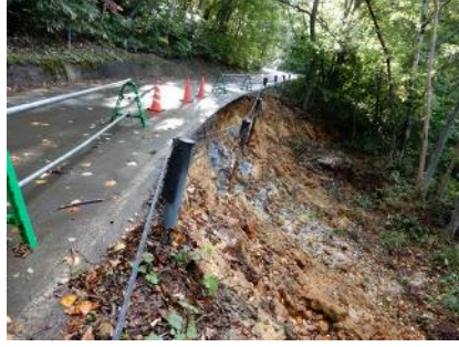
ゲートから200m付近路肩崩落部
