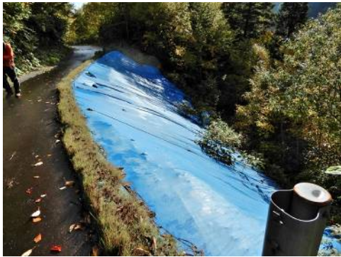
路肩崩落・幅員減少 (ゲートから約0.9km)
