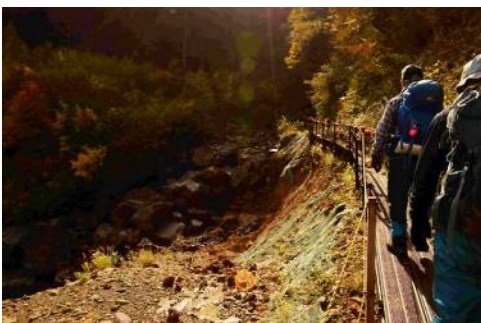
連絡道起点付近、赤川渡渉点手前の仮設栈橋杭基礎部が洗掘崩落。安全対策必要 (上村氏撮影)
