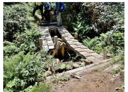
山荘直前の沢に架かる木歩道橋 桁受台が破損し歩道板が折れている
