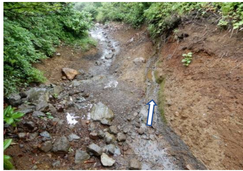
(No.21) 巧みな水切り 掘れた登山道側壁に水勾配の排水路
