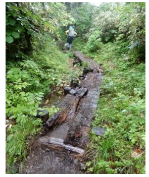
(No.19) 木道腐朽 歩行に支障なし
