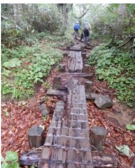
(No.7) 木道一部腐朽 歩行に支障なし
