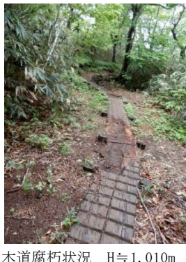
木道腐朽状況 H≒1,010m (下山時撮影)
