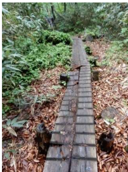
木道腐朽状況 H≒932m (下山時撮影)
