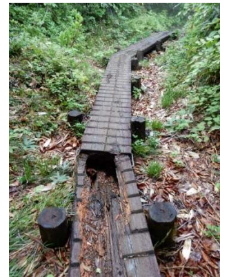
木道腐朽状況H≒1,030m
