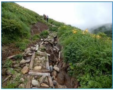
No.6 木柵詰石歩道、一部破損
