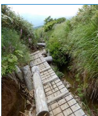
No.43 木道破損部 分岐から約230m付近
