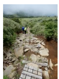
No.42 木階段 分岐から約150m付近
