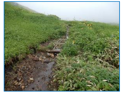
No.4 洗掘部の上端付近、 水切り設置が望まれる
