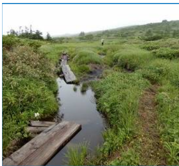
No.25 木道破損水没箇所 標柱から笹森山方向約300m付近
