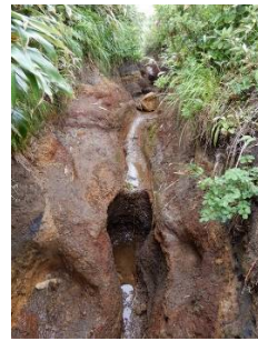
No.3 洗掘著しい
