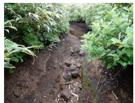
No.12 休暇村分岐近くの洗掘状況
