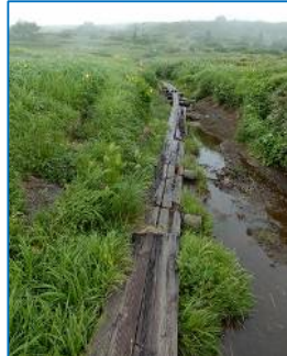
No.26 木道腐朽一部破損
