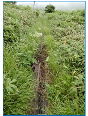
No.24 木道腐朽
